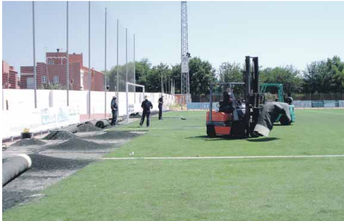
ESTADIO DEL SAN MARTÍN. Los operarios proceden a retirar el césped del campo de fútbol con ayuda de maquinaria.
